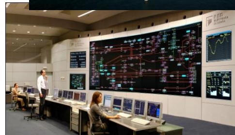
Windenergie im Kontrollzentrum
